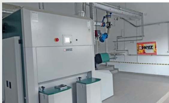
▲ Kotłownia zasilania biomasą w ZS Nr 1 w Kłobucku
