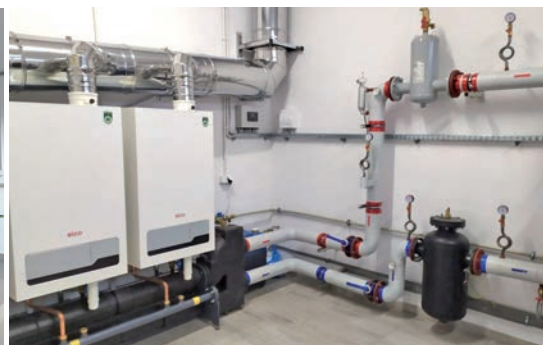
▲ Nowoczesna kotłownia gazowa w ZS w Krzepicach
