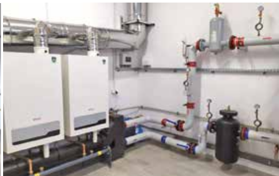
▲ Nowoczesna kotłownia gazowa w ZS w Krzepicach
